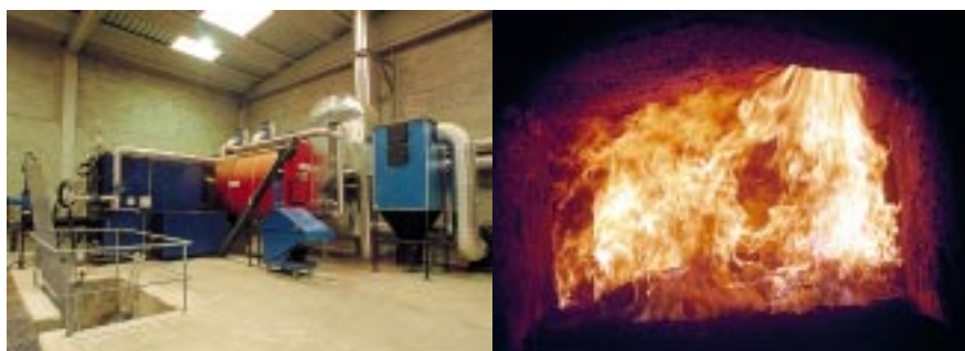
Imatge de la caldera de biomassa i de la cambra on té lloc la combustió de la matèria orgànica que arriba a la central.
